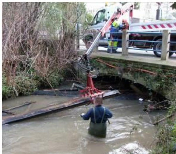
Enlèvement de planches accumulées sous un pont
